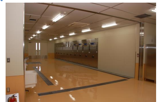
コンテナイン保管庫
