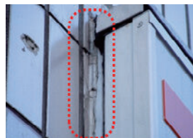
溶接部の劣化、コーキングの 劣化等
