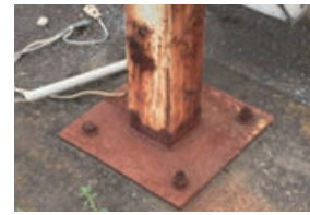
鉄骨のさび・ 塗装の老朽化
