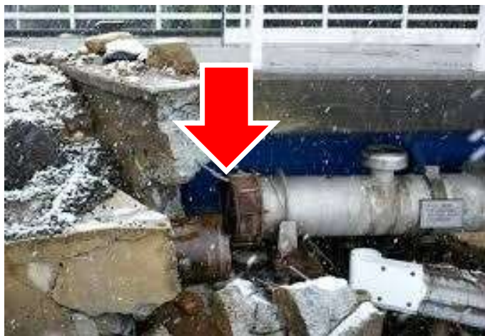
管路の被害(能登半島地震)
