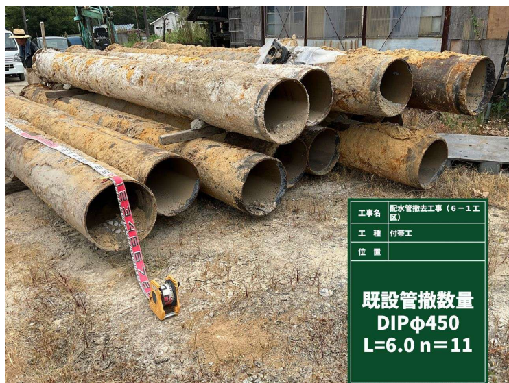
腐食した老朽管
