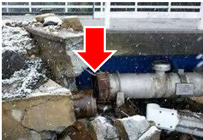
管路の被害(能登半島地震)
