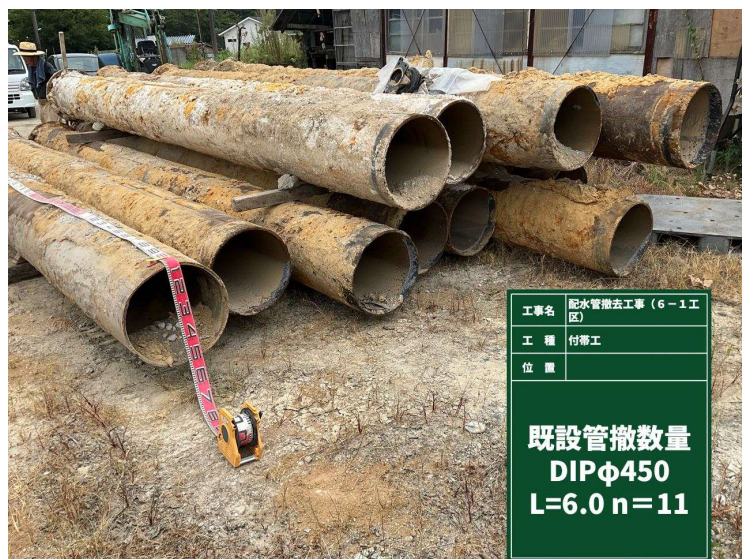
腐食した老朽管
