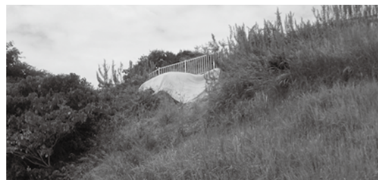
▲のり面の崩落(町道藤江線)
