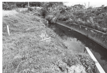
▲堤防修繕工事が必要な岡田川
