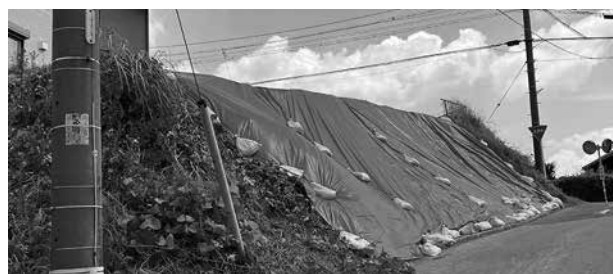
▲令和4年7月12日の大雨で発生した土砂災害
