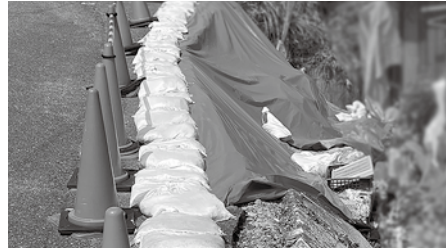
▲民家に土砂迫る、コンクリート擁壁崩壊現場(森岡字上山之上地内)
