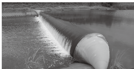
▲石ヶ瀬川のラバーダム
