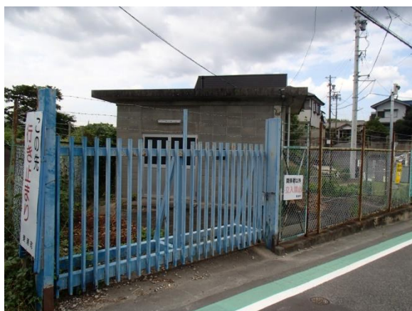
上米田ポンプ場
